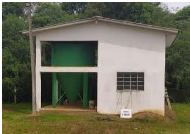
Figura 43 - Tratamento físico-químico inoperante.
